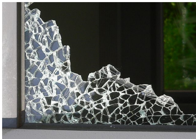
Рис. 3. «Пример разрушения закаленного стекла»
