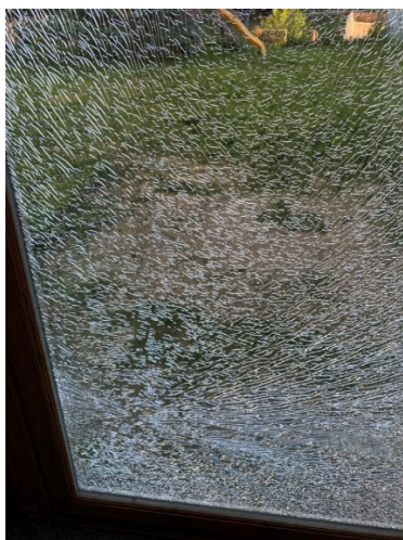
Рис. 1. «Пример разрушения ламинированного стекла»
